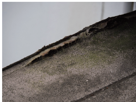
エッジの溶接剥がれ
